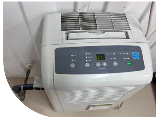
Deshumidificador con tubería de drenaje.
