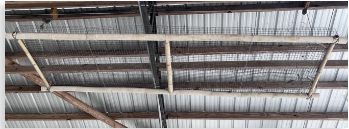
Figura 3. Rejilla de secado suspendida cerca de la parte inferior de un techo metálico. Fuente: Tim Motis
