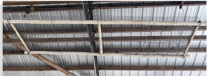
Figure 3. Support de séchage grillagé suspendu près de la face inférieure d'un toit métallique. Source: Tim Motis
